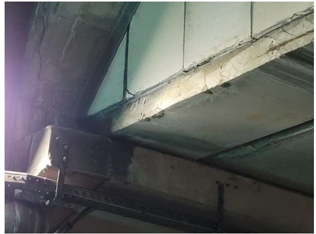
풍도슬래브 하면 S54 파손
