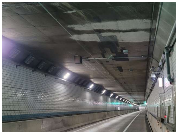
부대시설 S59 신호기 상태양호
