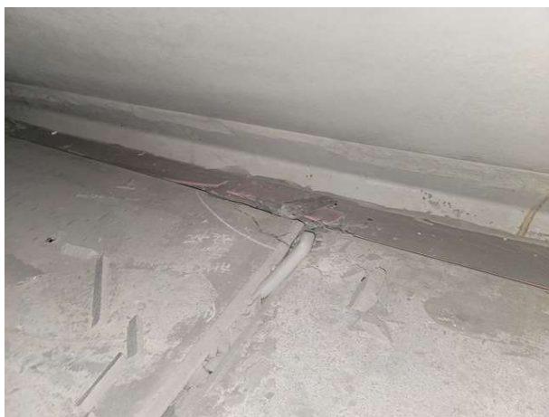
풍도슬래브 상면 S53 파손
