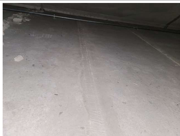
풍도슬래브 상면 S52 이음부 물탈 파손
