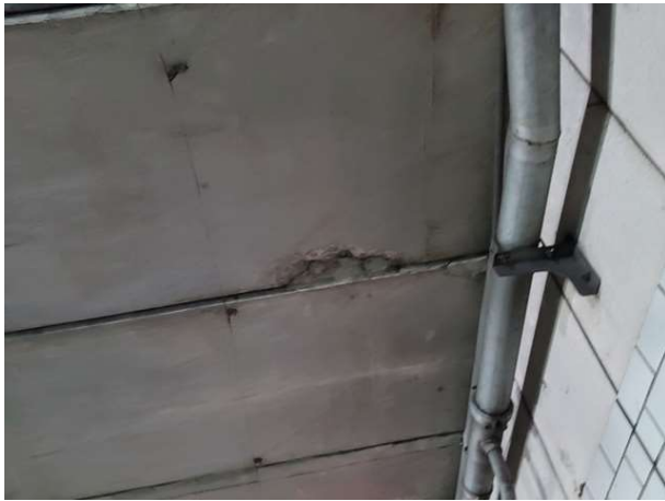
풍도슬래브 하면 S54 파손
