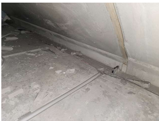
풍도슬래브 상면 S54 파손
