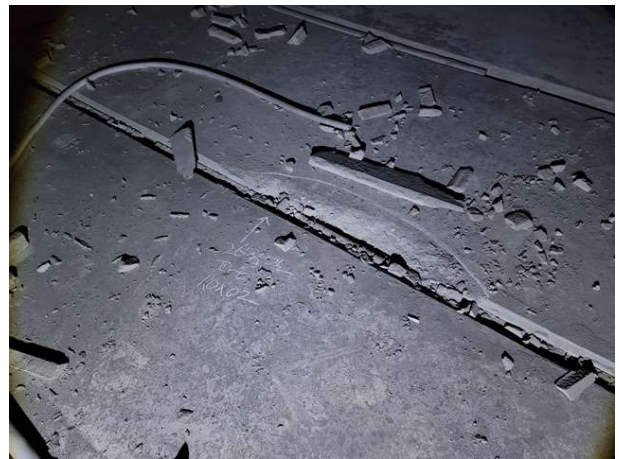
풍도슬래브 상면 S54 파손
