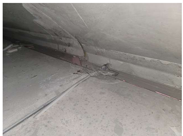
풍도슬래브 상면 S54 파손
