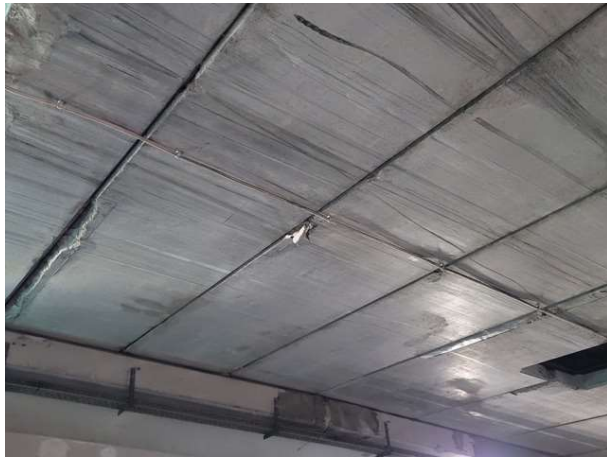
풍도슬래브 하면 S54 파손
