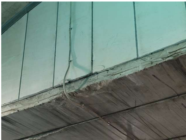
풍도슬래브 하면 S54 파손
