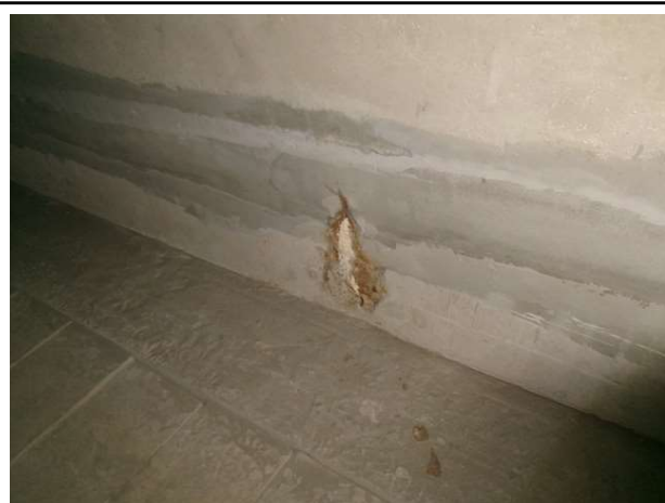
NATM구간 측벽부 S46 균열 및 누수(스며있음)
