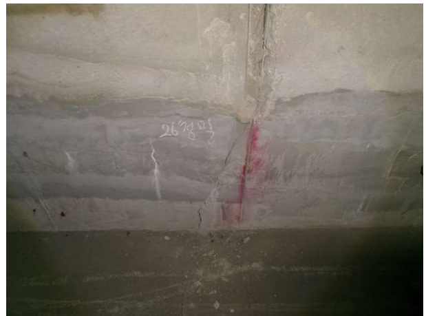
NATM구간 측벽부 S47 내부벽체 파손
