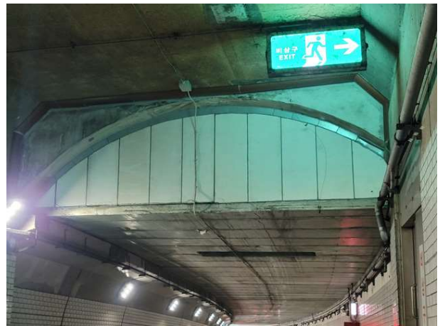
풍도슬래브 격벽 S54 파손
