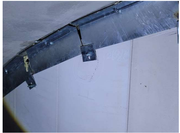
풍도슬래브 격벽 S54 파손
