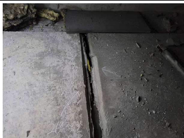
풍도슬래브 상면 S54 파손
