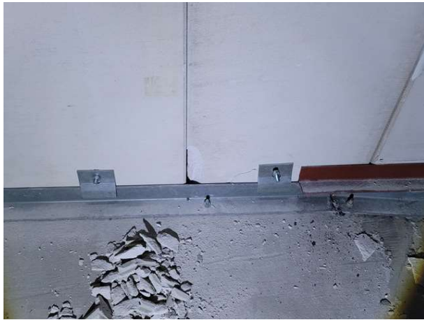
풍도슬래브 격벽 S54 파손
