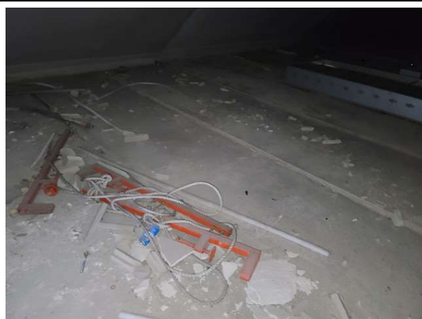
풍도슬래브 상면 S54 이음부 몰탈파손
