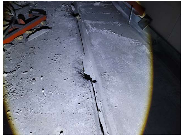
풍도슬래브 상면 S54 파손
