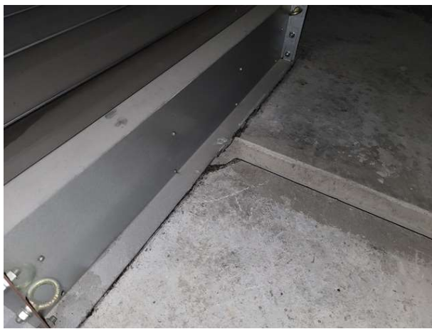
풍도슬래브 상면 S53 파손
